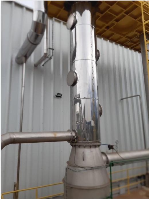
Figura 12. Tubulações para passagem de gases na Unidade em Rifaina.
