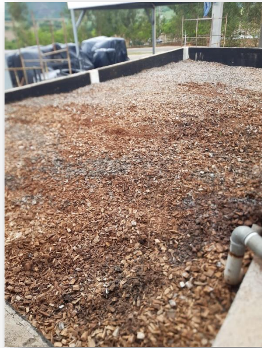
Figura 13. Filtro Biológico com cavacos de pinus na Unidade em Rifaina.
